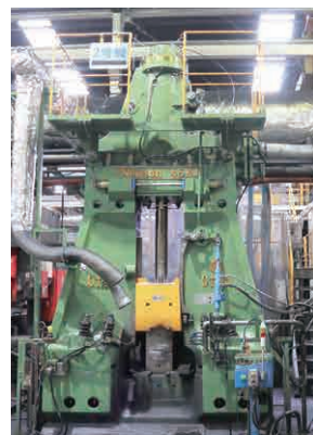
大智鍛造所で稼働する大谷機械製作所製の鍛造設備
